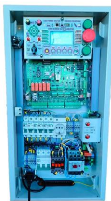
Шкаф управления А6 (Блок БМ)
