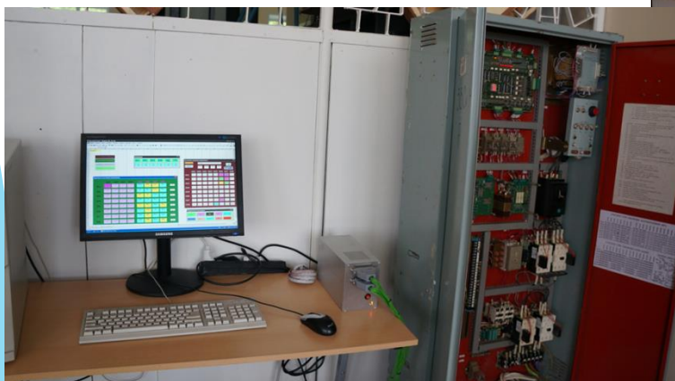
Проверочно-испытательный стенд на уровень квалификации электромеханика
